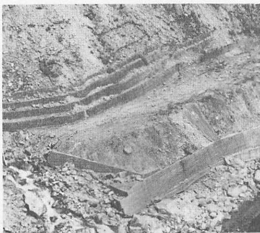
植生復元のための基礎工事が行なわれたが表土の移動がはげしく植生は何も出現していない
